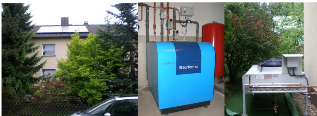
Abb. 5 – Flachkollektoren auf dem Dach des Zweifamilienwohnhauses sowie chillii® STC8 Adsorptionskältemaschine und Trockenrückkühler (Quellen: SolarNext)
